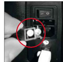
Abbildung 6: Defekte Hauptsicherung und Ersatzsicherung
